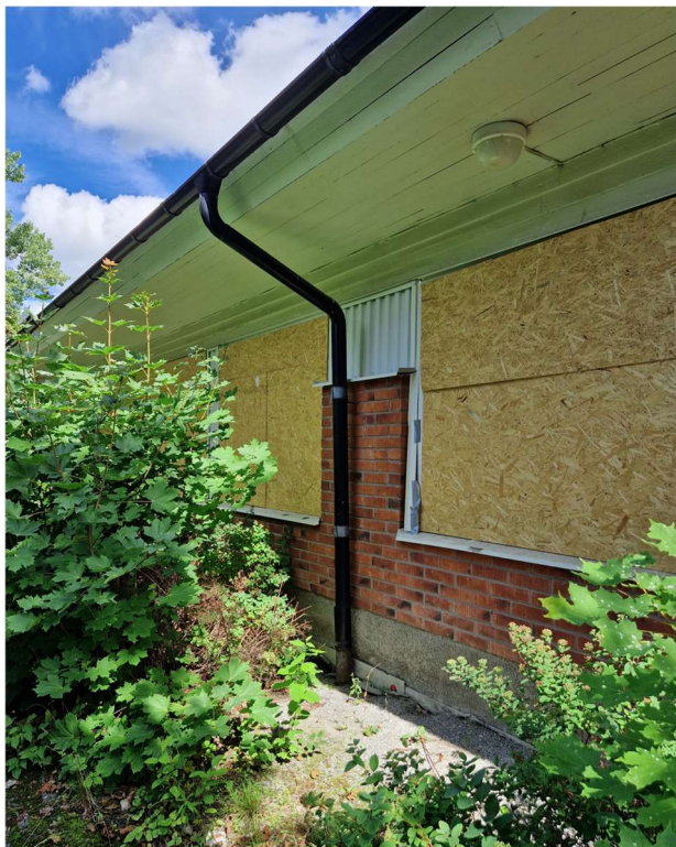
Figur 12. Stuprör som går ned i marken och troligen är direktanslutet till ledningsnätet.
